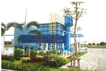
ระบบผลิตน้ำประปาจากน้ำฝน
