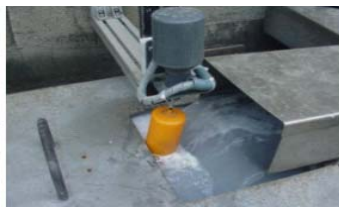
ท่อระบายน้ำ (กรณีน้ำล้น)
