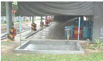
ที่ชำระล้างร่างกาย (Emergency Shower)
